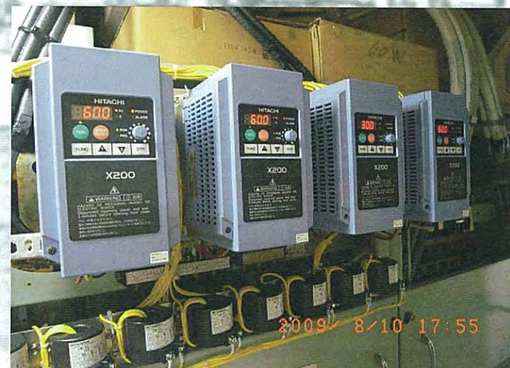
インバーターの設置状況
