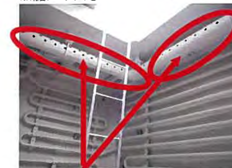
魚艙内写真①(ブライン配管あり)
