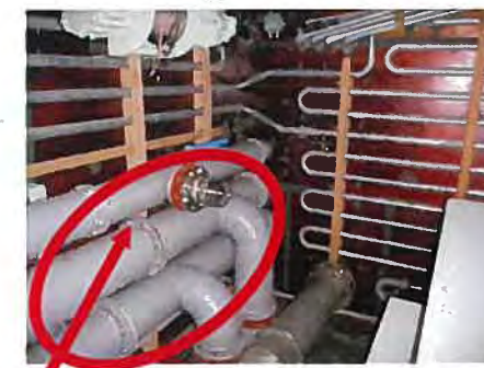
保冷艙内写真③(ブライン配管あり)
