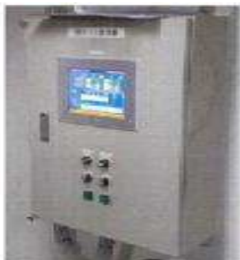
見える化制御盤
