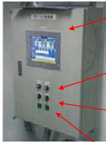
見える化制御盤
