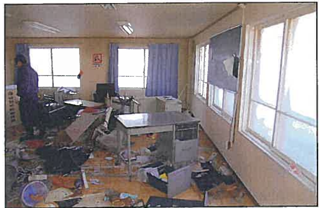
【市場事務所内冠水被害】
