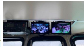
監視モニター
